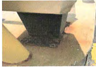
Paystation bottom rusting
